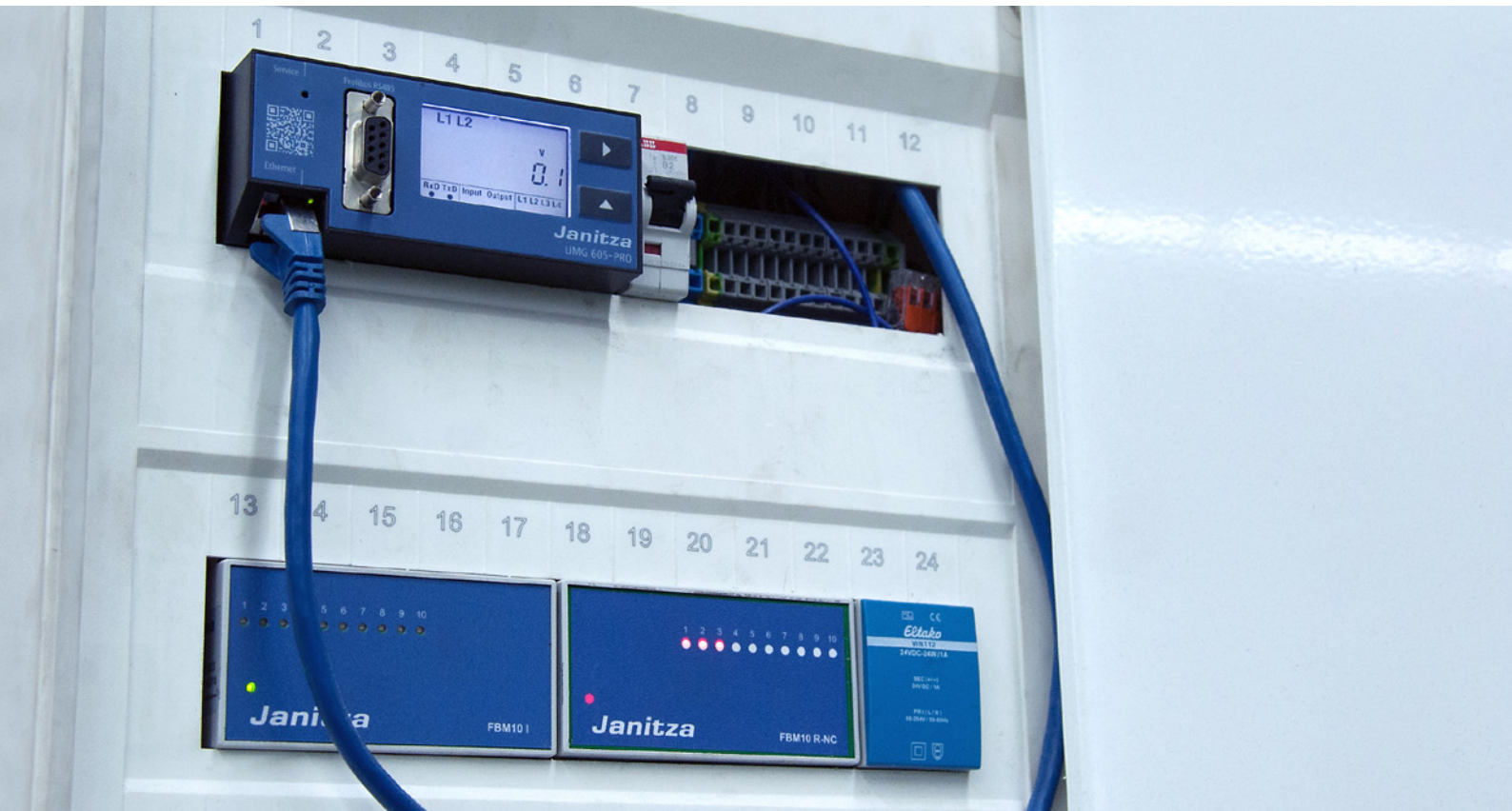
Der Janitza Netzanalysator UMG 605-PRO bezieht den Synchronisationsimpuls direkt vom Stromzähler des Energieversorgers.
