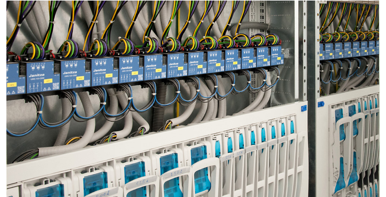
Messgeräte UMG 103 an den Leistungsschaltern der Unterverteilungen
