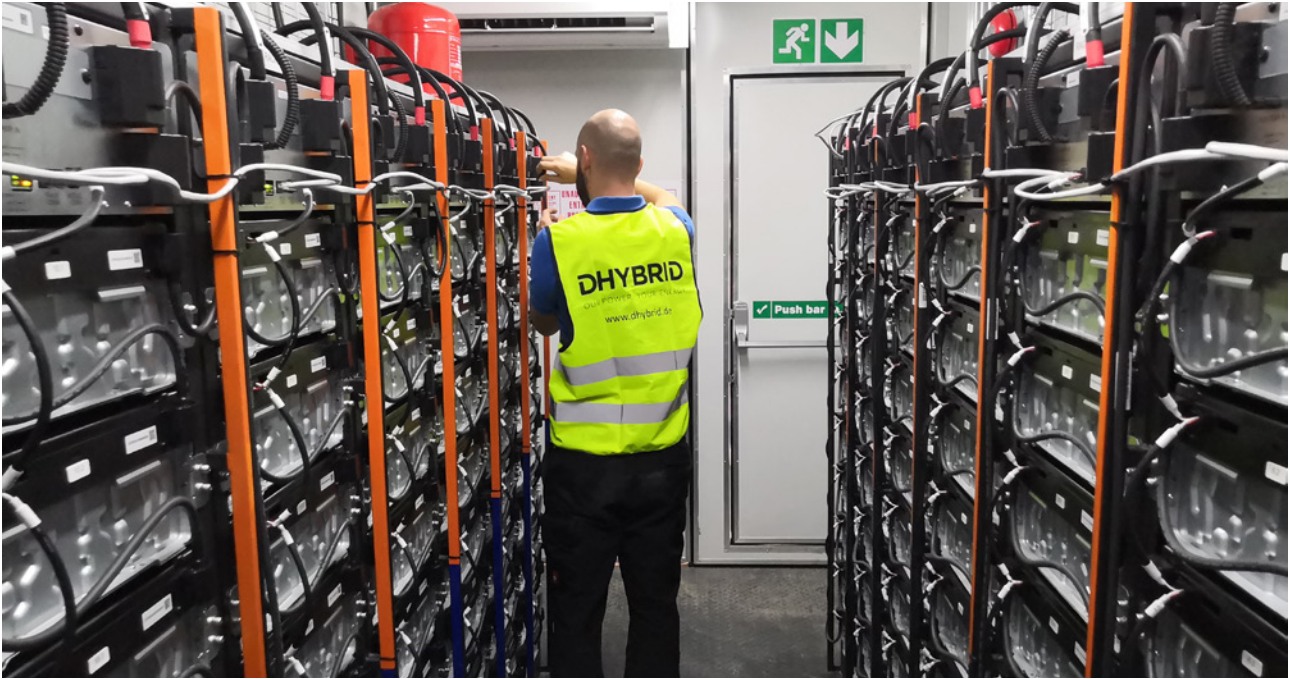
Con una capacidad de 1027 kWh, las unidades de memoria de iones de litio cubren las noches y los días con poco sol
