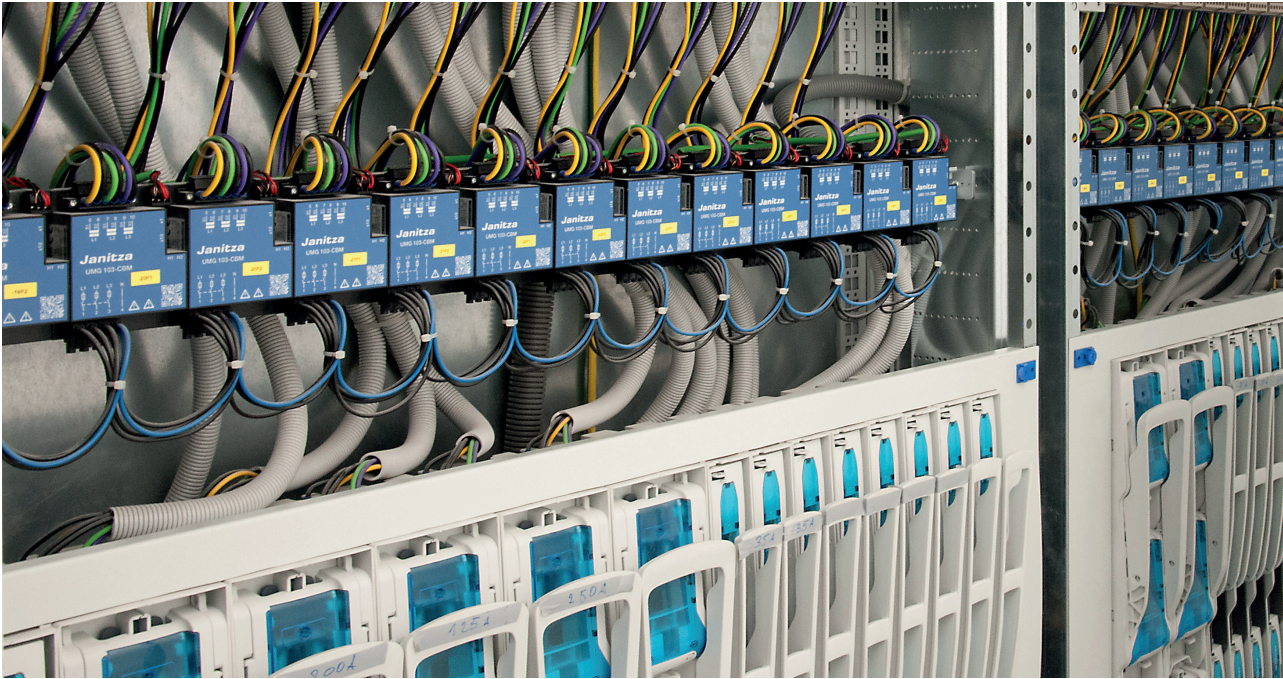
Dispositivos de medición UMG 103 en los disyuntores de los cuadros de subdistribución
