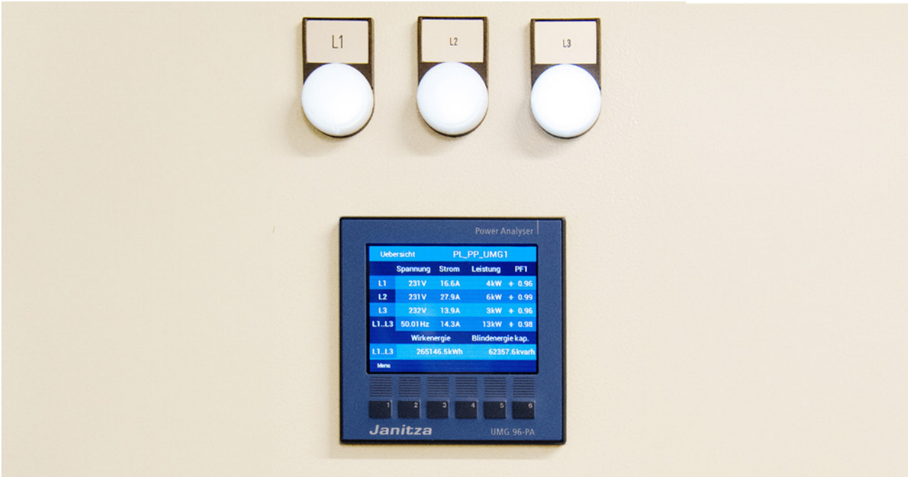
Netzanalysatoren UMG 96-PA von Janitza ersetzen die alten Türeinbaugeräte
